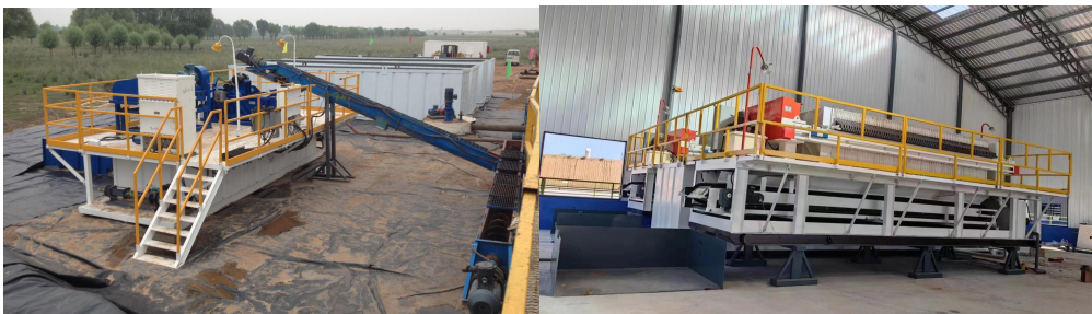
图 3.6-2 泥浆不落地循环系统
